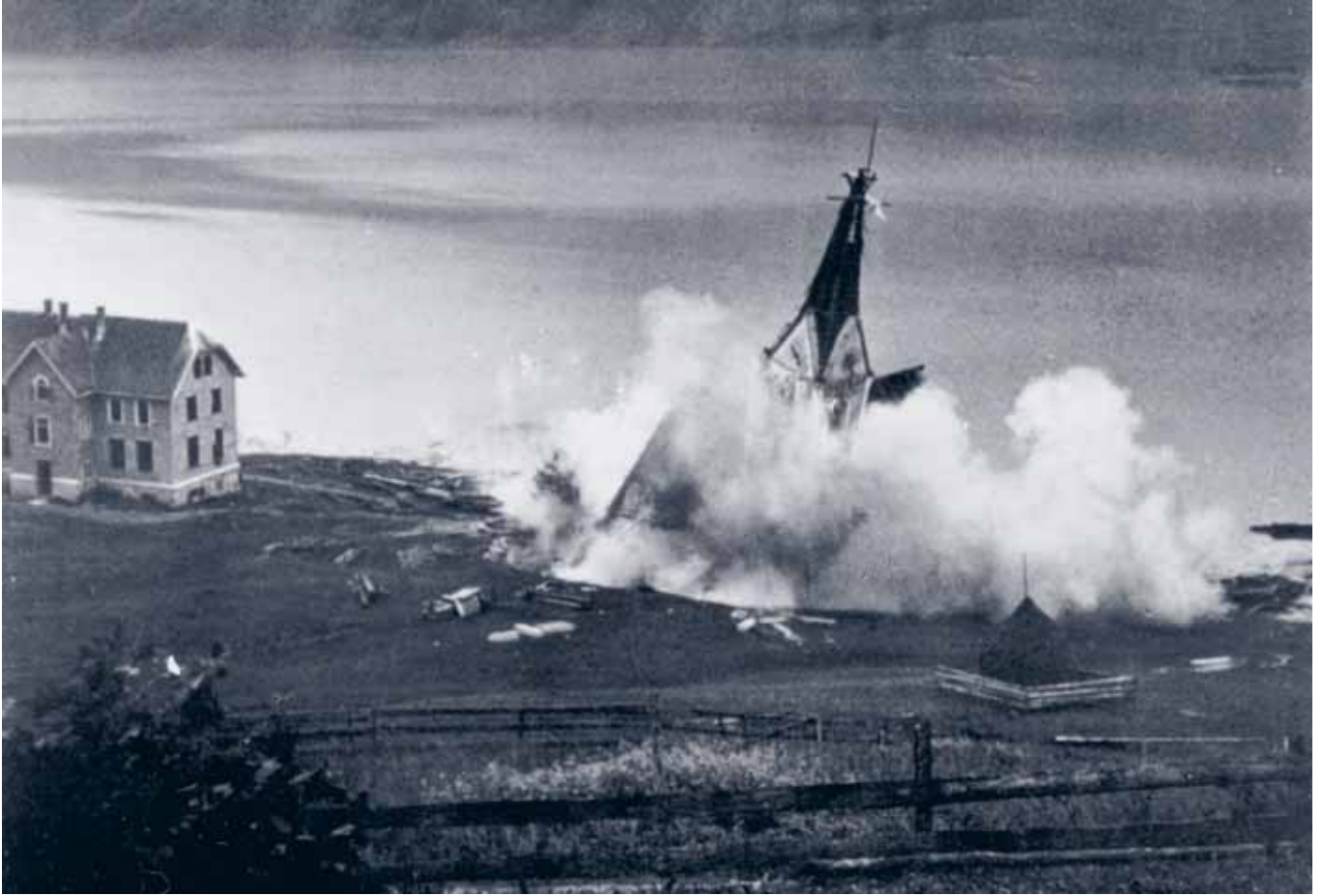
Ab 1924 begann das Wasser im Stausee zu steigen. Auch die Dorfkirche von Alt-Innerthal musste weichen; sie wurde gesprengt.
